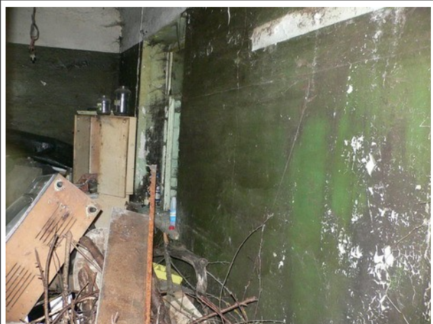
Hinnatav hoone sisemus on rämpsü tõttu läbimatu
